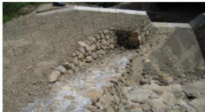
動物逃生坡道
