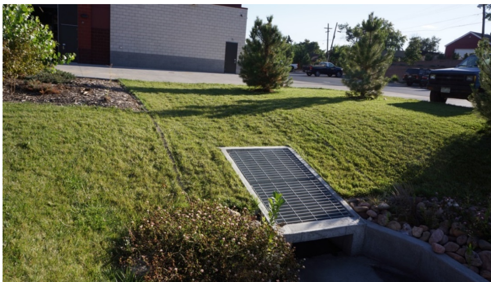
照片 5-4(A) 斜依式出流工及攔污柵設施
