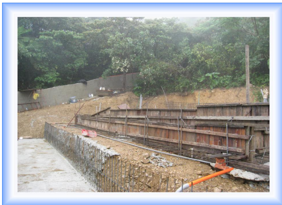
相片 7-1 新店違規巡查現場照片
