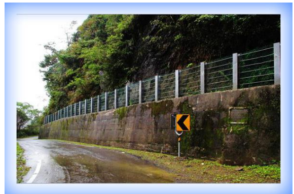
相片 4-12 烏來區信福路-防落石柵欄
