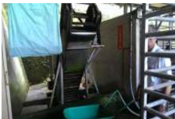
相片 3-7 養鹿場固液分離設施
