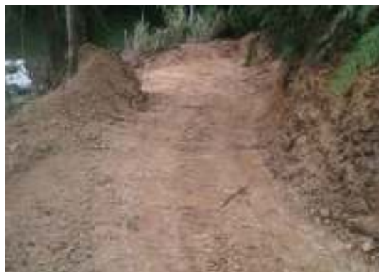
相片 7-2 新店違規巡查現場照片
