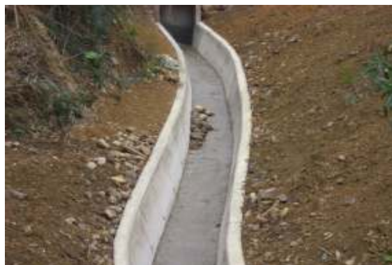
相片 4-12 坪林里下坑子口-U 型溝
