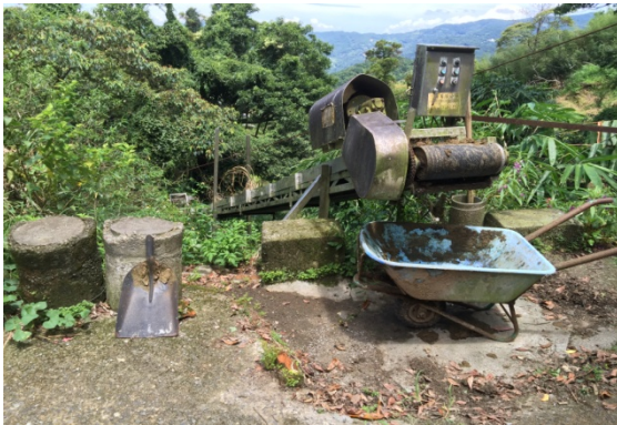
相片 3-7 養鹿場固液分離設施
