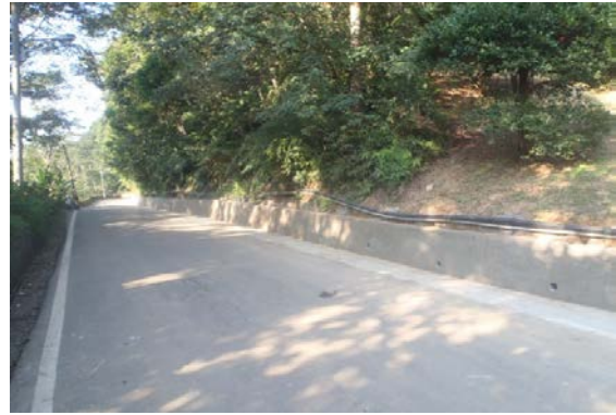
相片 4-26 下石厝路-L 型排水溝
