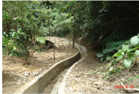
相片 4-6 塗潭 30 號旁-U 型溝
