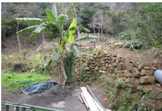
相片 3-5 擅自設置擋土牆
