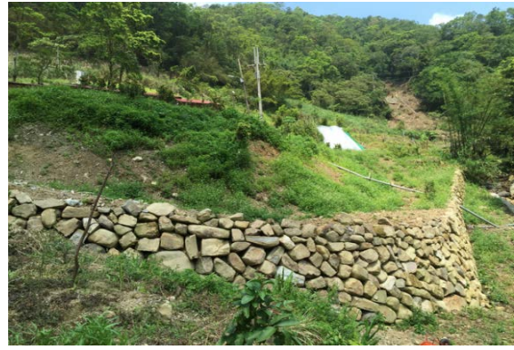
相片 3-2 擅自設置擋土牆
