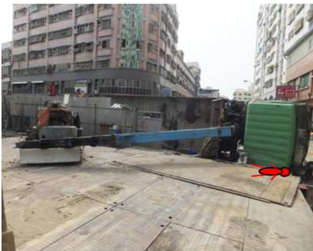
▲勞工被翻覆卡車起重機壓傷現場概況
