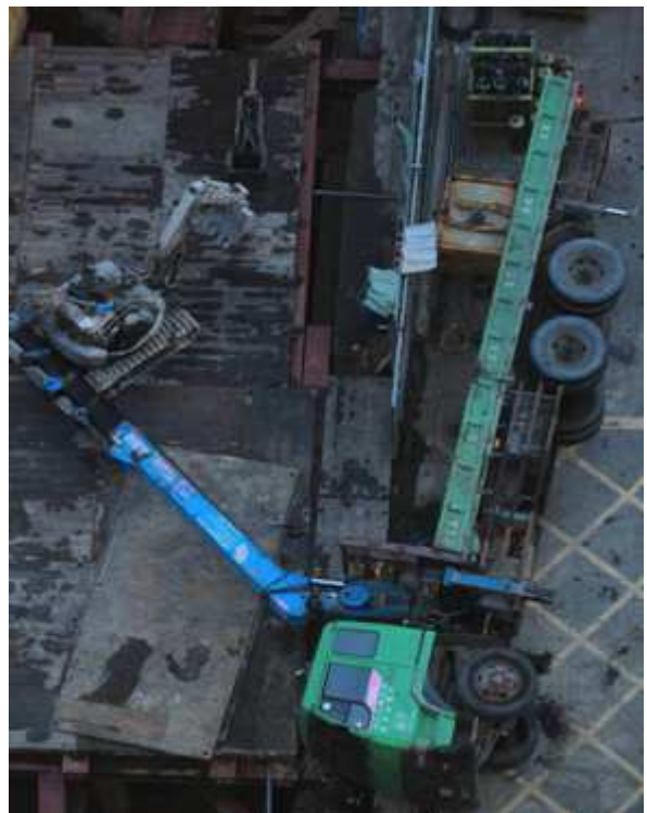
卡車起重機及挖土機翻覆現場概況 ▶
