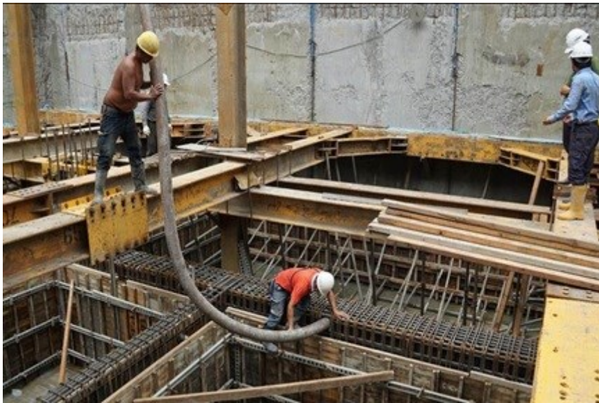
圖6 灌漿工站立於不安全位置施工且未繫掛安全帶
