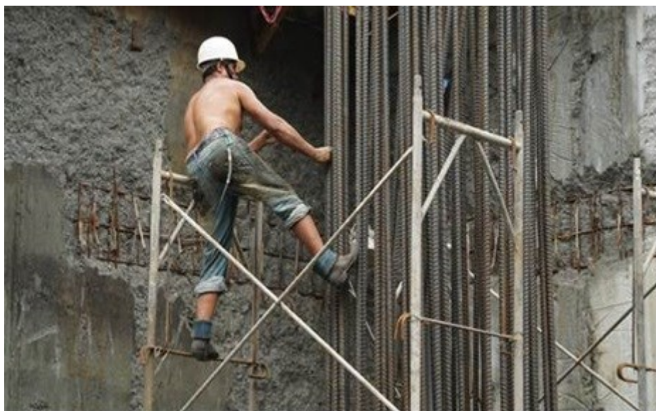
圖3 鋼筋工站立於不安全位置調整鋼筋且未繫掛安全帶
