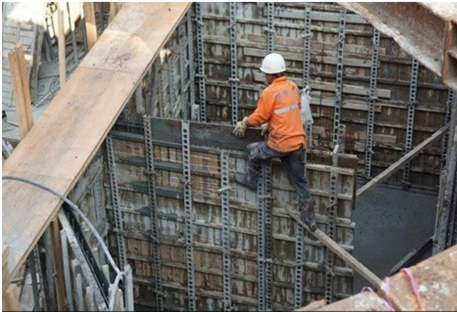
圖5 模板工站立於不安全位置調整模板且未繫掛安全帶
