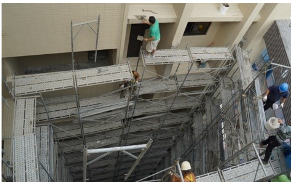
圖4 泥作工站立於不安全位置施工且未繫掛安全帶
