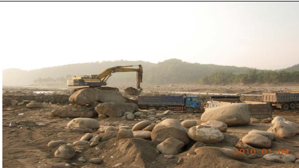
99.01.04 高雄市杉林區旗山溪杉林大橋旁河川公地未經主管機關申請許可挖掘及搬運土方
