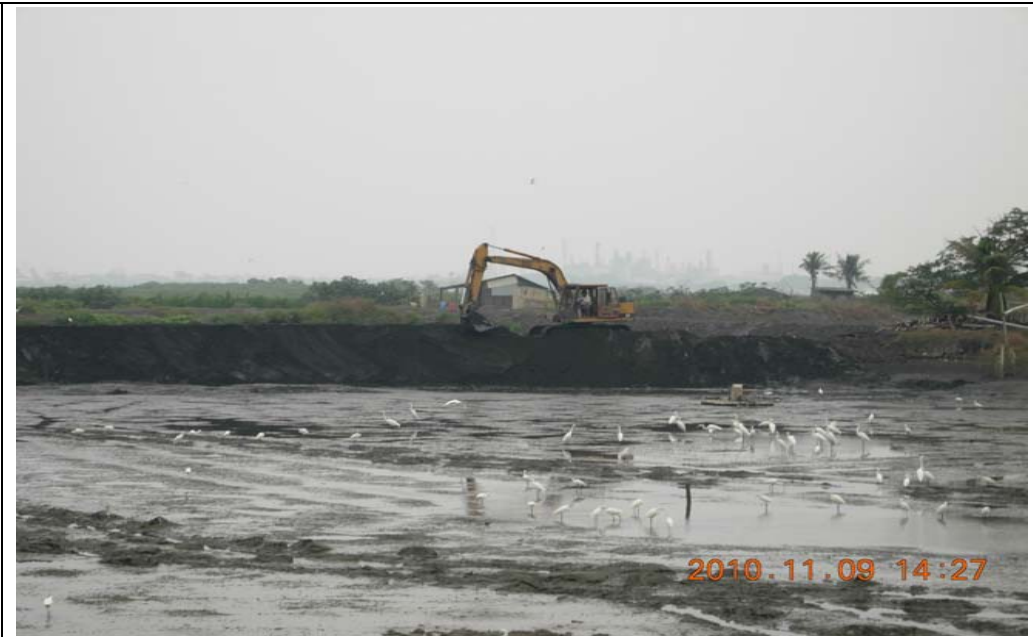
99.11.09 屏東縣新園鄉新園堤防共和段未經許可僱請挖土機於河川區域進行舊有漁塭整復
