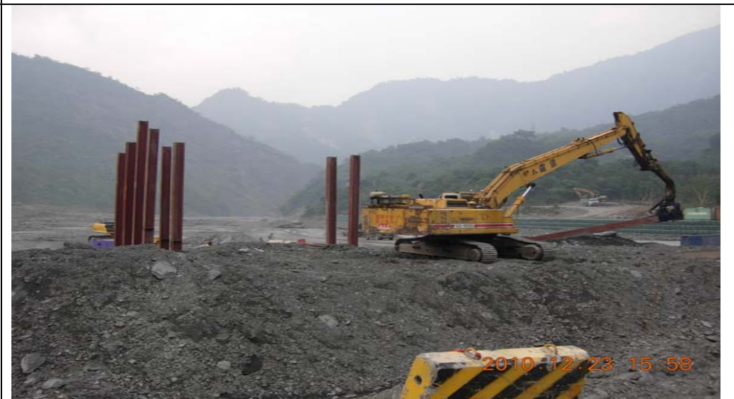
99.12.23 屏東縣霧台鄉隘寮北溪原伊拉橋河川區域未經申請許可施設鋼便橋
