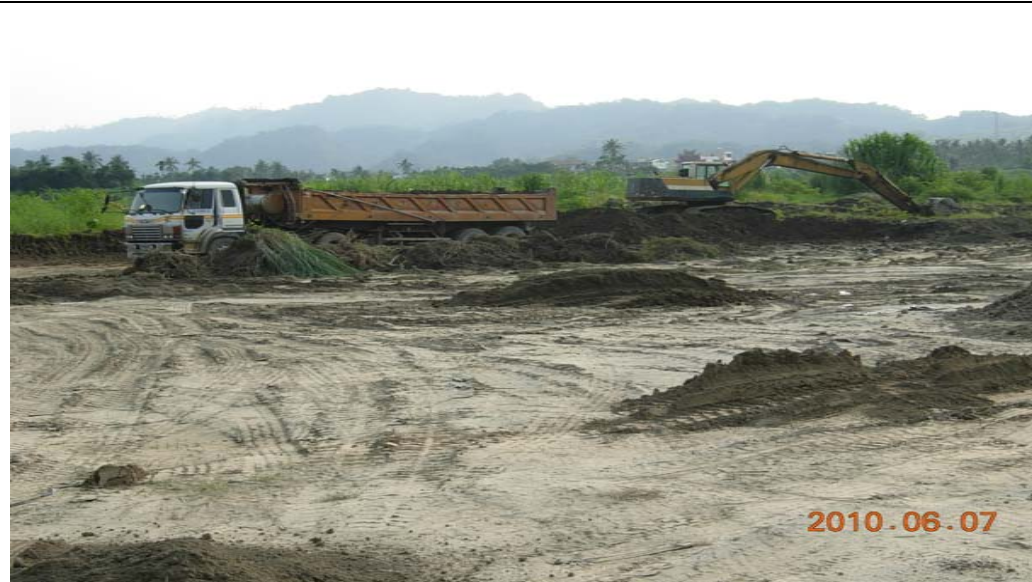
99.06.07 高雄市旗山區旗南堤防尾河川區域未經申請許可盜採砂石
