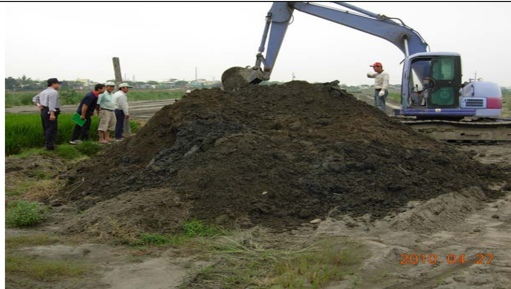
99.04.27 高雄市大寮區赤崁段河川公地未經申請許可於河川區域內進行挖掘行為
