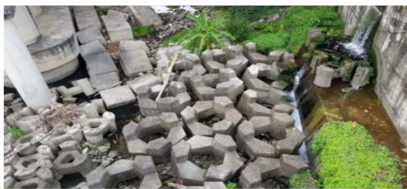
(b)橋墩下保護工現況景觀雜亂
