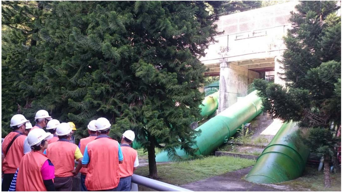
4 支高壓鋼管是將上游大甲溪水流引至發電機組，利用水頭差推動渦輪發電
