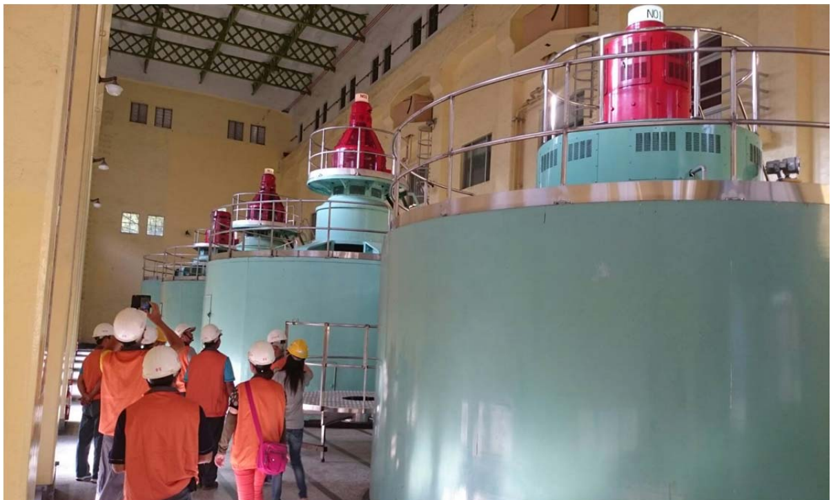
眼前是 1-4 號發電機組，5 號機組在隧道內
