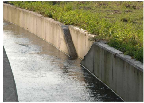
圖 18 堤岸落差過高
