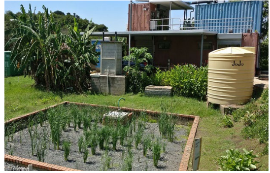
圖 12 生態濕地污水處理系統(南非) 9
