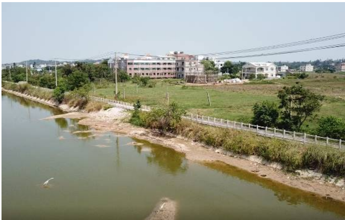
<既有漿砌塊石護岸(幾近崩壞)>
