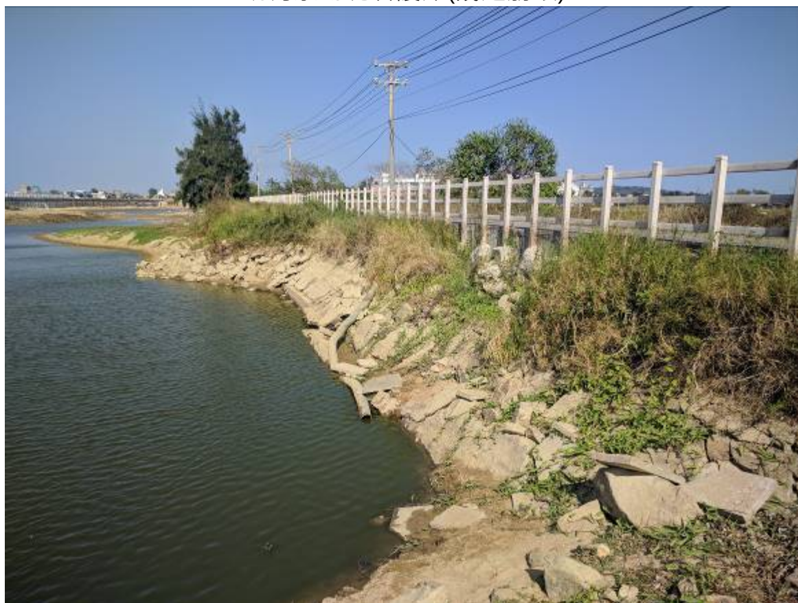
<既有漿砌塊石護岸(幾近崩壞)>
