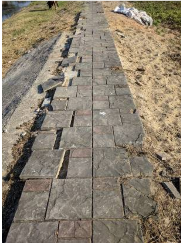
<既有步道損壞嚴重>
